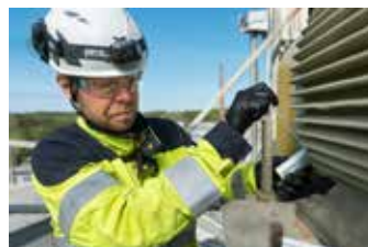
Schaeffler OPTIME wird montiert.
